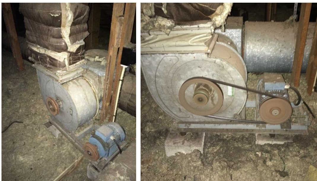
Figur E.1.2 - Foto af to ventilatorer til udsugning før renoveringen af Skoleparken, TV. uden rem
