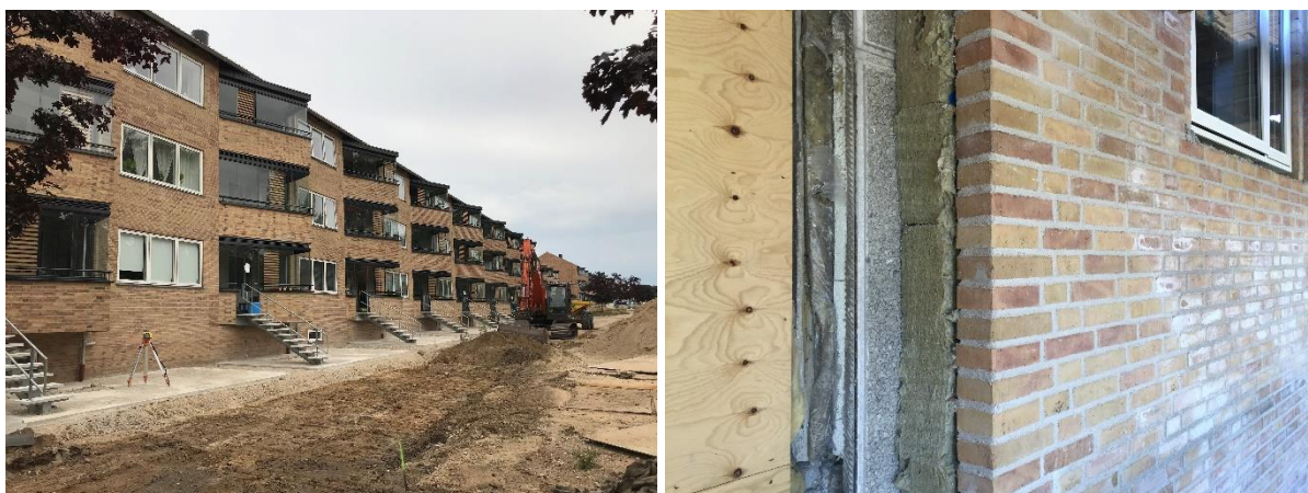
Figur E.2.3 - TV en næsten færdig bygning med de nye altaner og adgang til det grønne fællesområde. TH ses det hvordan den grå eksisterende facade er efterisoleret og beklædt med tegl
